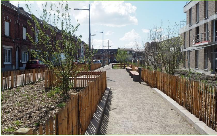
Chantier d'espaces publics MOA La fabrique des quartiers- MOE Tandem+, Agence Leblanc Venacque, Strate
